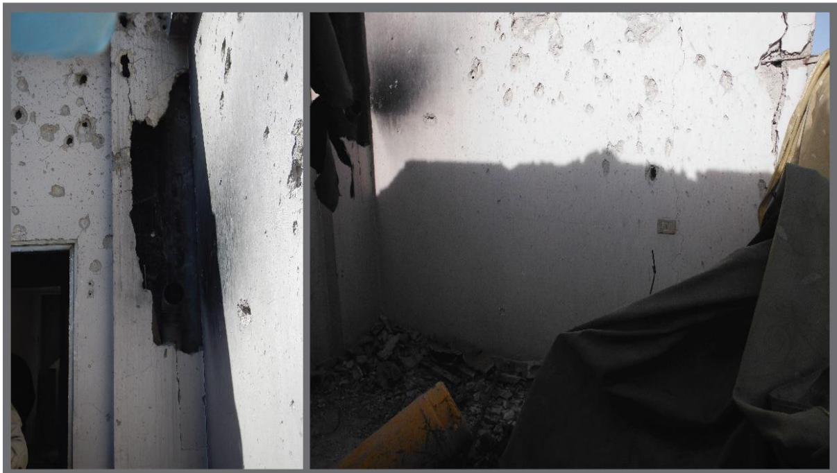
图片 18：屋顶层墙壁上部的照片。碎片模式与爆炸情形不吻合（来源：事实调查组）
