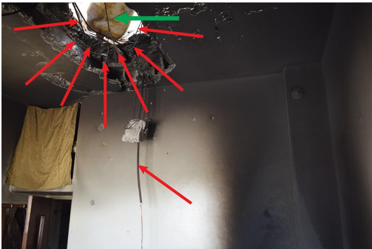
РИСУНОК 11. ВИДИМАЯ ВОРОНКА В КРЫШЕ В МЕСТЕ 2, СФОТОГРАФИРОВАННАЯ ИЗ ПОМЕЩЕНИЯ, РАСПОЛОЖЕННОГО НЕПОСРЕДСТВЕННО ПОД НЕЙ. ВИДНЫ ЧАСТЬ ЖЕЛТОГО ПРОМЫШЛЕННОГО БАЛЛОНА (ОТМЕЧЕН ЗЕЛеноЙ СТРЕЛКОЙ) И ОТЛОЖЕНИЯ ПОЧЕРНЕВШЕГО НАГАРА НА ПОТОЛКЕ И СТЕНАХ. НА СТЕНАХ НЕ ВИДНО ОСКОЛОЧНЫХ ПОВРЕЖДЕНИЙ, СООТВЕТСТВУЮЩИХ ВЗРЫВУ
