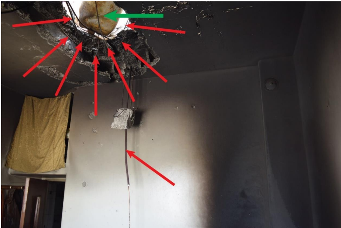
ILLUSTRATION 11 : CRATÈRE VISIBLE SUR LE TOIT À L'EMPLACEMENT N° 2, PHOTOGRAPHIÉ DEPUIS LA PIÈCE SITUÉE DIRECTEMENT EN DESSOUS. UNE PARTIE DU CYLINDRE INDUSTRIEL JAUNE (MARQUÉ PAR UNE FLÈCHE VERTE) ET DES DÉPÔTS DE SUIE NOIRCISANTE SUR LE PLAFOND ET LES MURS SONT VISIBLES. AUCUNE TRACE DE FRAGMENTATION CORRESPONDANT À UNE EXPLOSION N'EST VISIBLE SUR LES MURS
