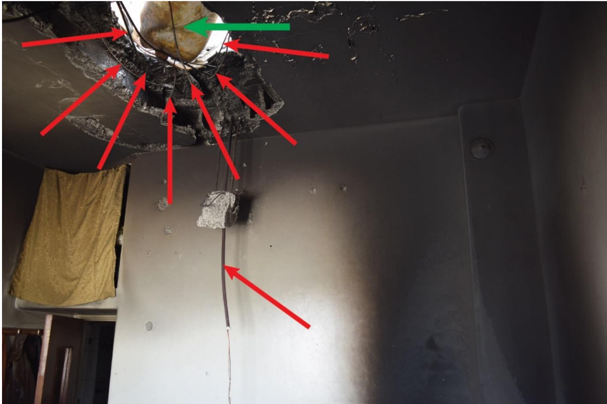
FIGURA 11: CRÁTER VISIBLE EN LA AZOTEA DEL LUGAR 2 FOTOGRAFIADO DESDE LA HABITACIÓN DIRECTAMENTE DEBAJO. PUEDEN VERSE PARTE DE LA BOMBONA AMARILLA INDUSTRIAL (MARCADA CON UNA FLECHA VERDE) Y LOS DEPÓSITOS DE HOLLÍN ENNEGRECIDO EN EL TECHO Y LAS PAREDES. NO SE OBSERVA NINGUNA PAUTA DE DAÑO DE FRAGMENTACIÓN EN LA PARED COMPATIBLE CON LA EXPLOSIÓN.
