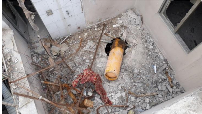
FIGURA 28: BOMBONA SOBRE EL SUELO DE LA AZOTEA EN EL LUGAR 2
