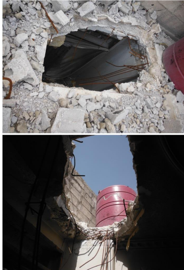
FIGURA 33: AGUJERO EN EL TEJADO DEL LUGAR 4, VISTO DESDE ARRIBA Y DESDE ABAJO
